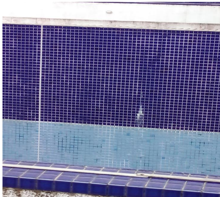
Figura 02 – Fachada com processo de eflorescência, calcinação e falhas nos rejuntos.
