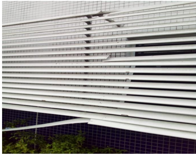
Figura 01 – Brises da fachada com avarias
